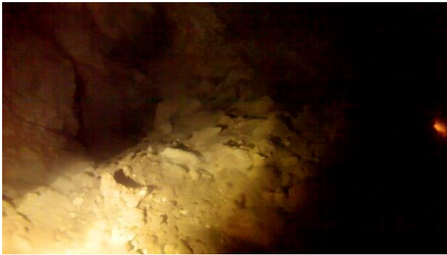
Dóm problémov - pohľad na stranu prítoku, kde sa stráca voda pod závalom
